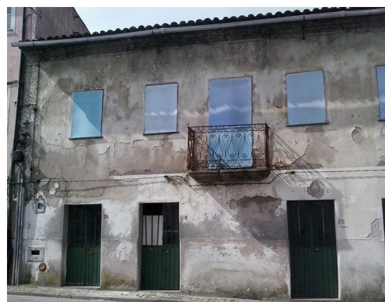
65 | Manchas, bolores e desagregação de argamassa
