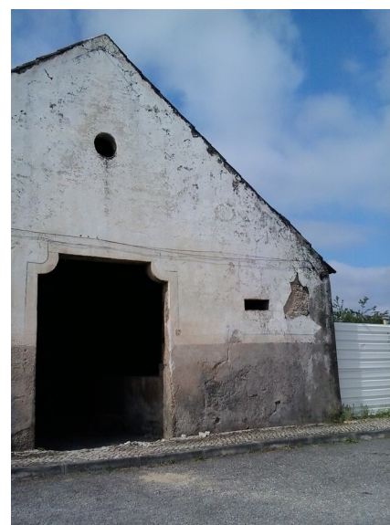
66 | Desagregação de reboco
