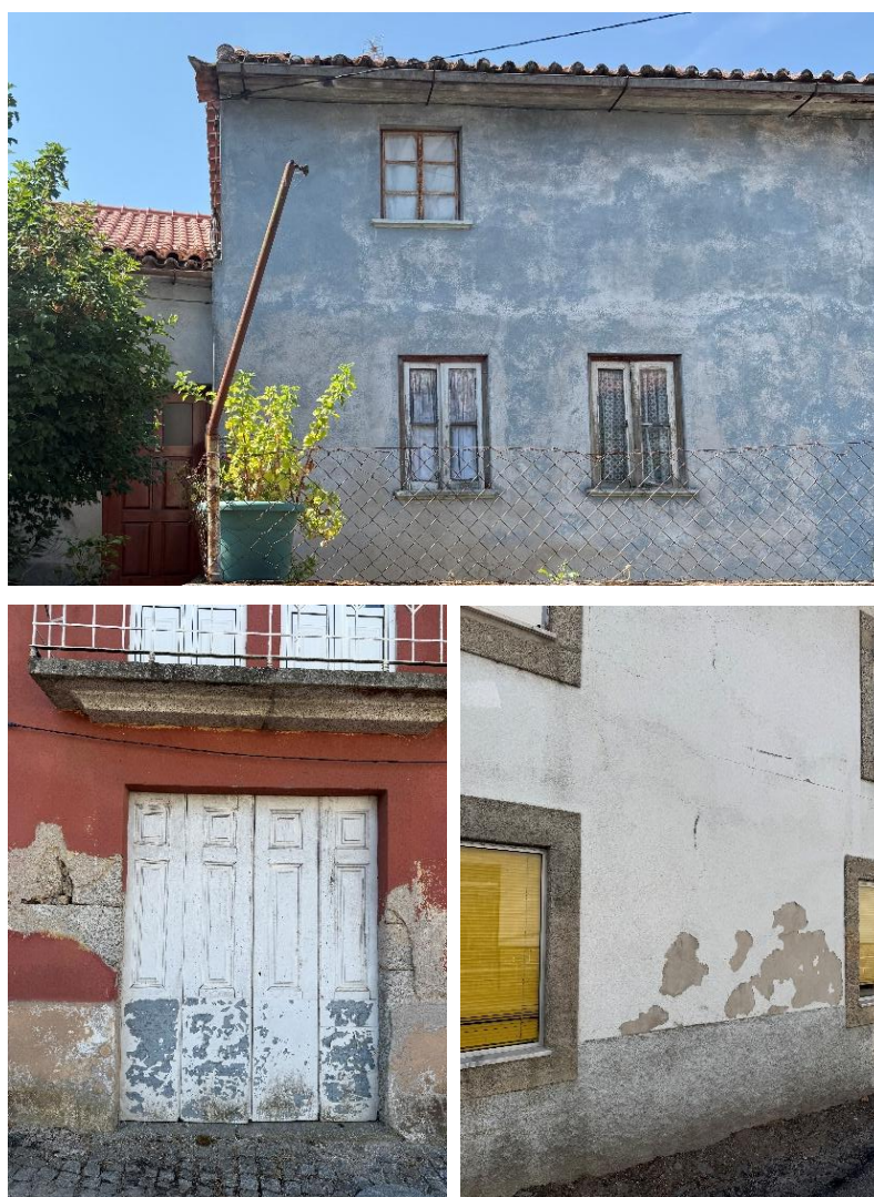
Figura 35. Desagregação do reboco
