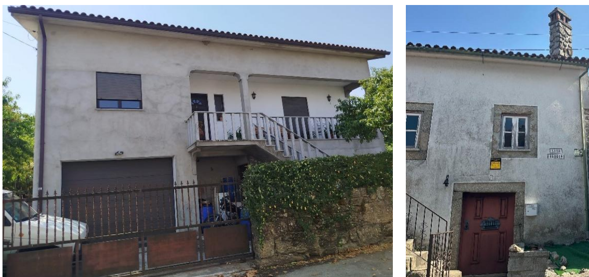
Figura 33. Manchas nas fachadas
