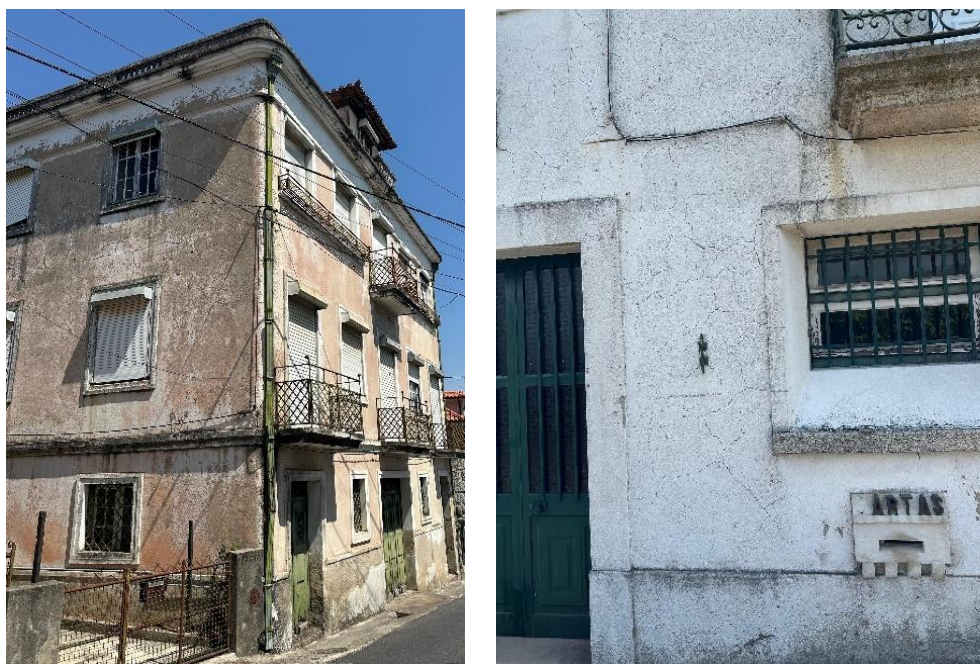
Figura 34. Fachadas com fissuras
