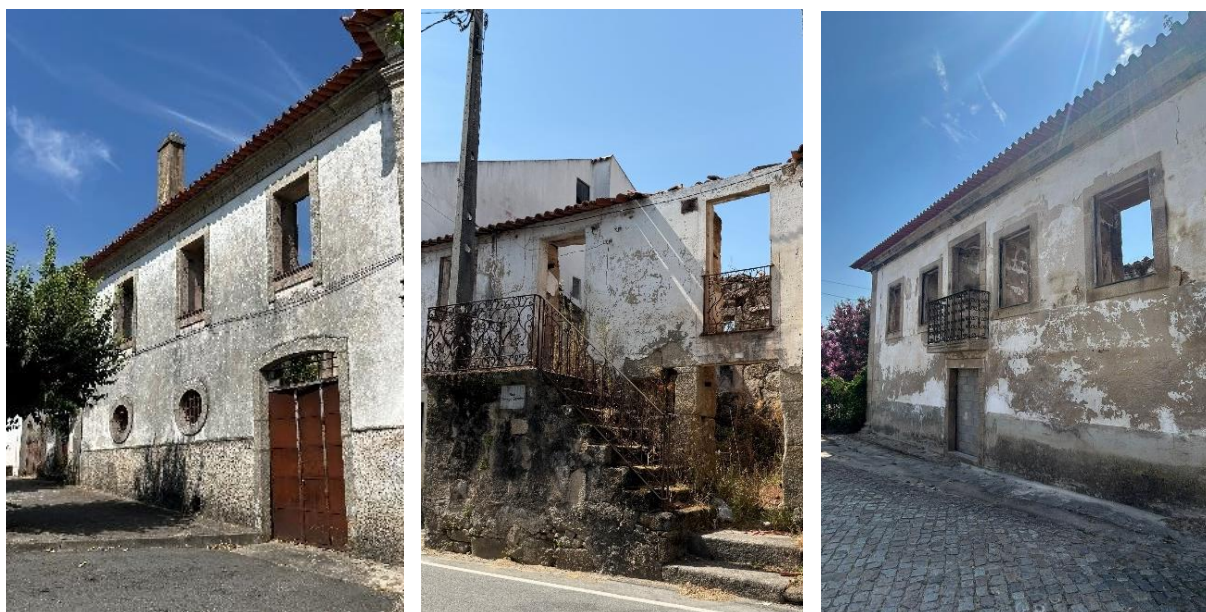
Figura 41. Edifícios com ausência de caixilharia
