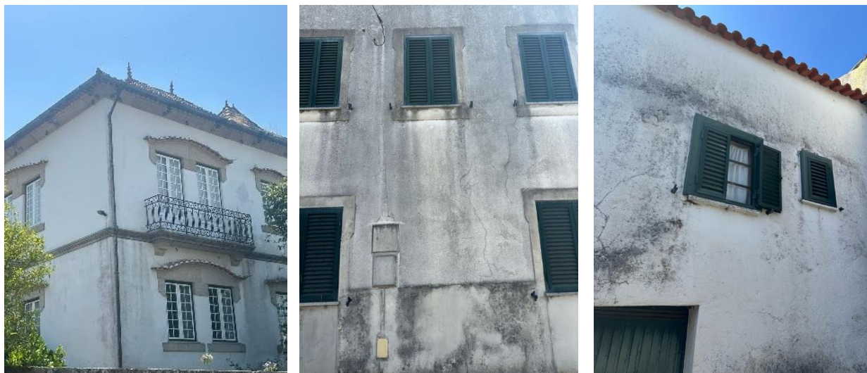
Figura 36. Manchas nas fachadas
