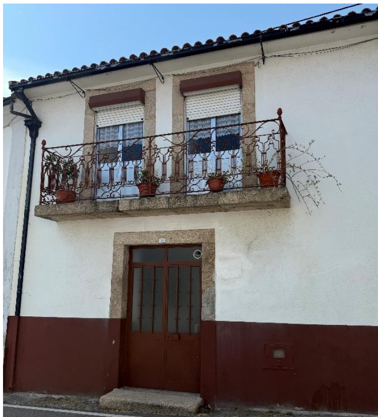
Figura 33. Cobertura com caleira
