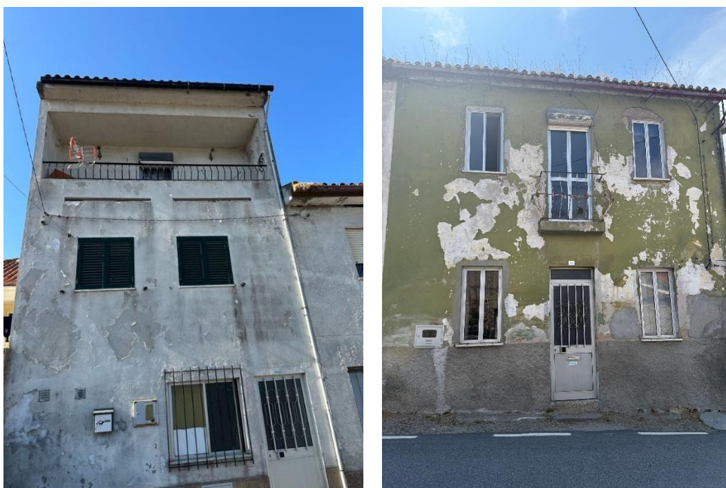
Figura 38. Desagregação do reboco
