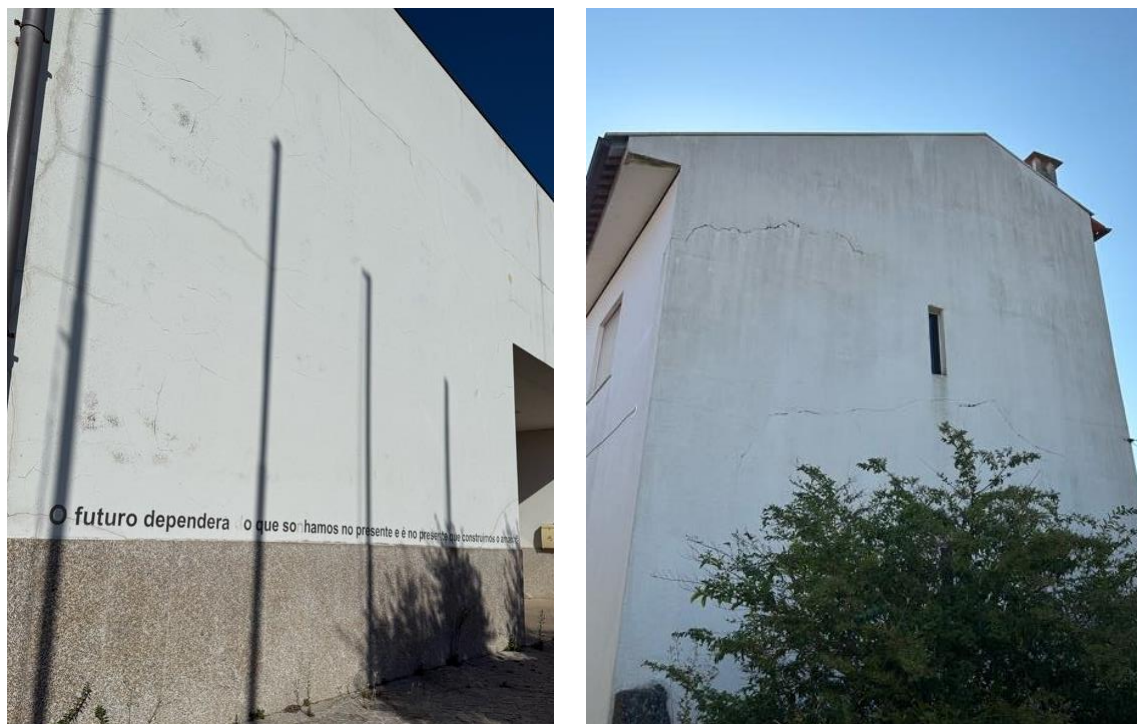
Figura 37. Fachadas com fissuras
