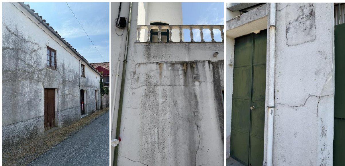
Figura 41. Fachadas com fissuras
