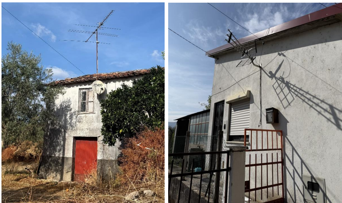
Figura 43. Presença de máquinas de AC e antenas de televisão
