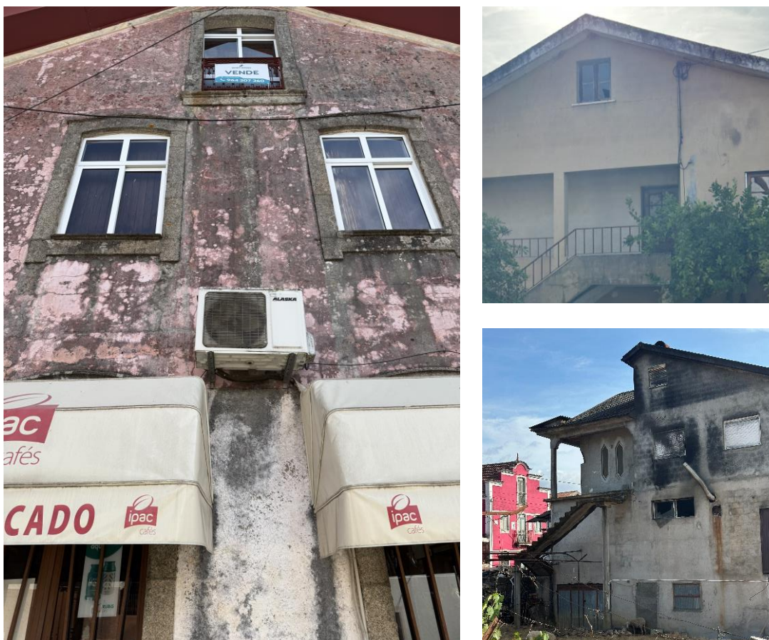
Figura 40. Manchas nas fachadas
