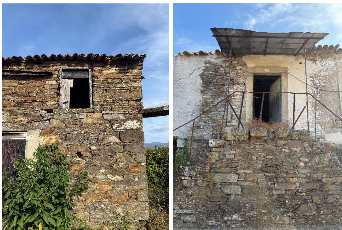
Figura 45. Edifícios com ausência de caixilharia
