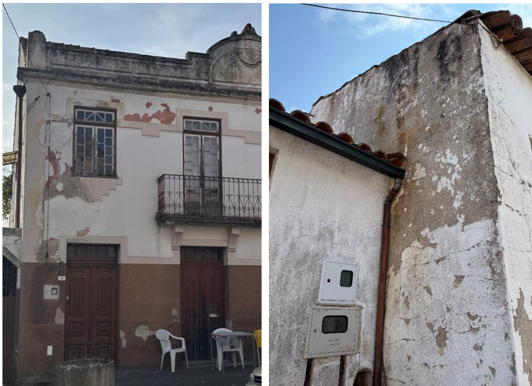
Figura 42. Desagregação do reboco
