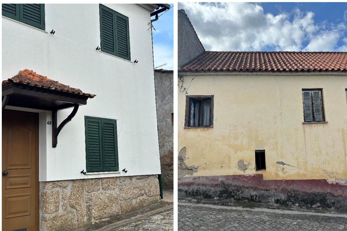
Figura 34. Fachadas com fissuras
