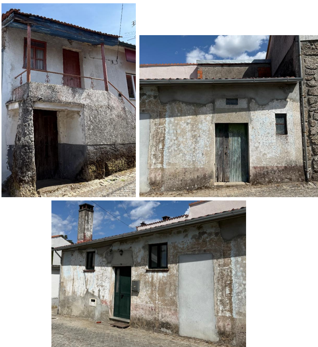
Figura 33. Exemplos de manchas nas fachadas
