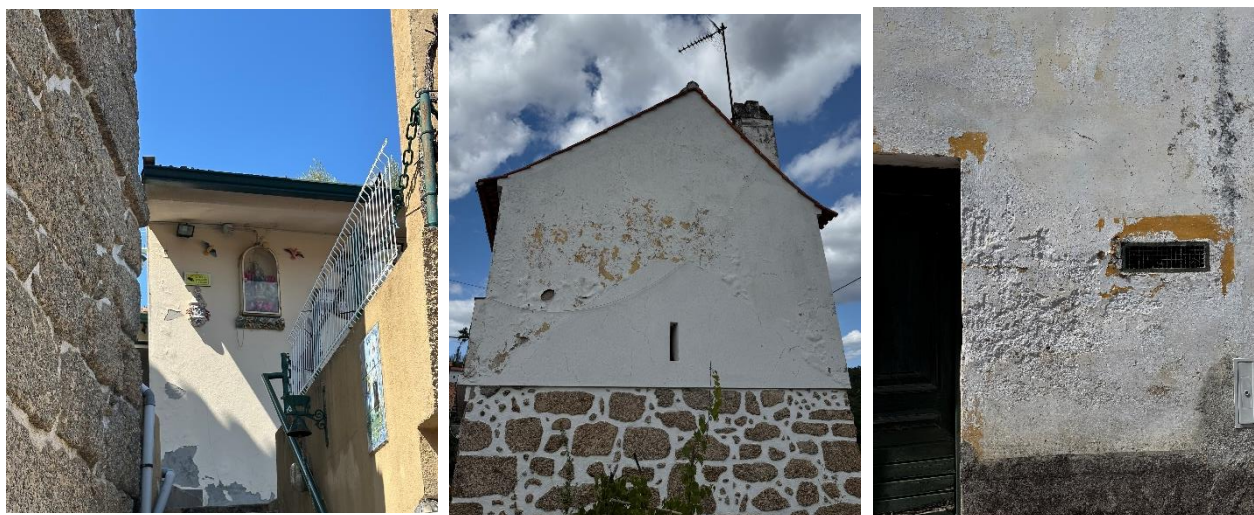
Figura 35. Fachadas com desagregação do reboco
