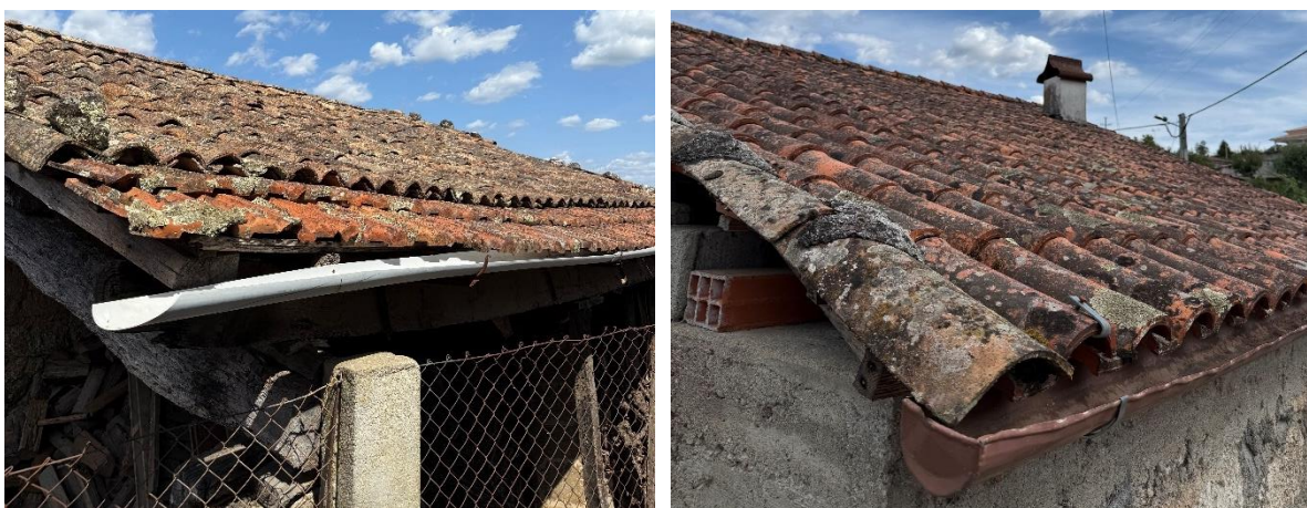
Figura 31. Exemplos de coberturas deformadas
