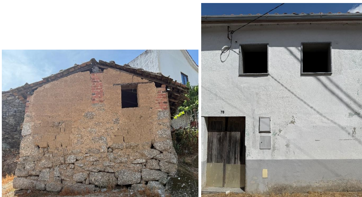
Figura 38. Edifícios com ausência de caixilharia
